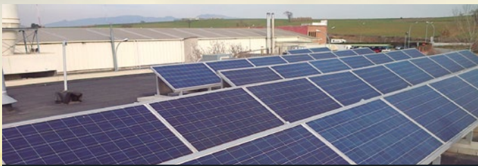
Instalaciones en ámbito industrial o sector terciario
